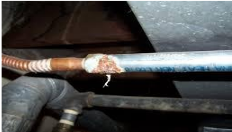
الشكل (1-3) يوضح التآكل الكلفاني.
