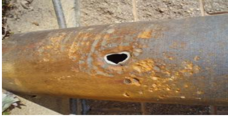
الشكل (1-4) يوضح التآكل النقر.
