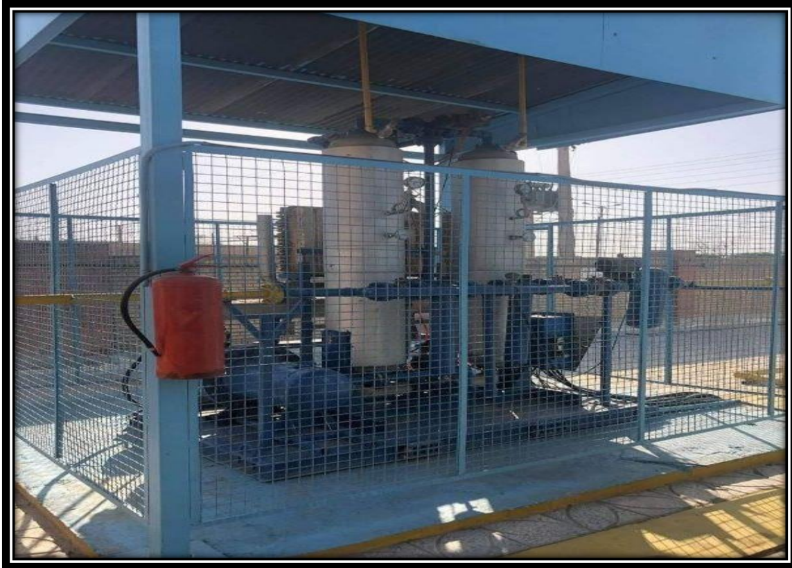
الصورة (32) منظومة غاز للبنىات السكنية
