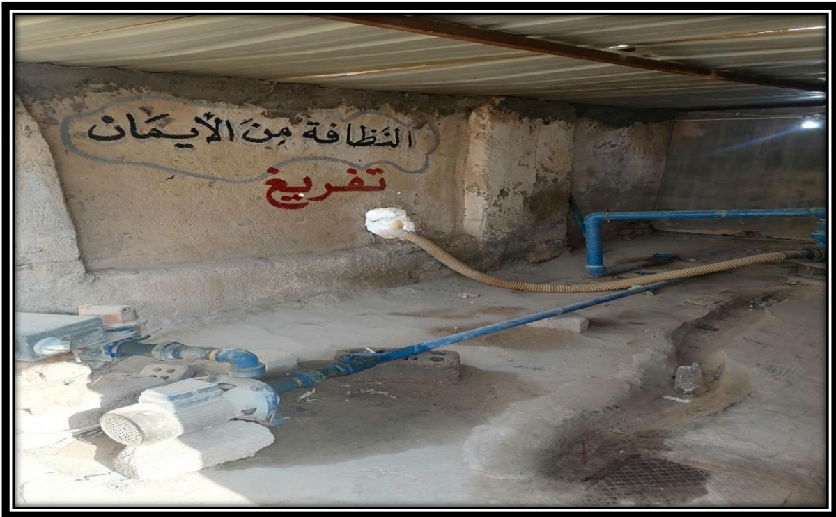
الصورة (29) غرفة تفريغ النفط داخل الساحة في قضاء مركز كربلاء
