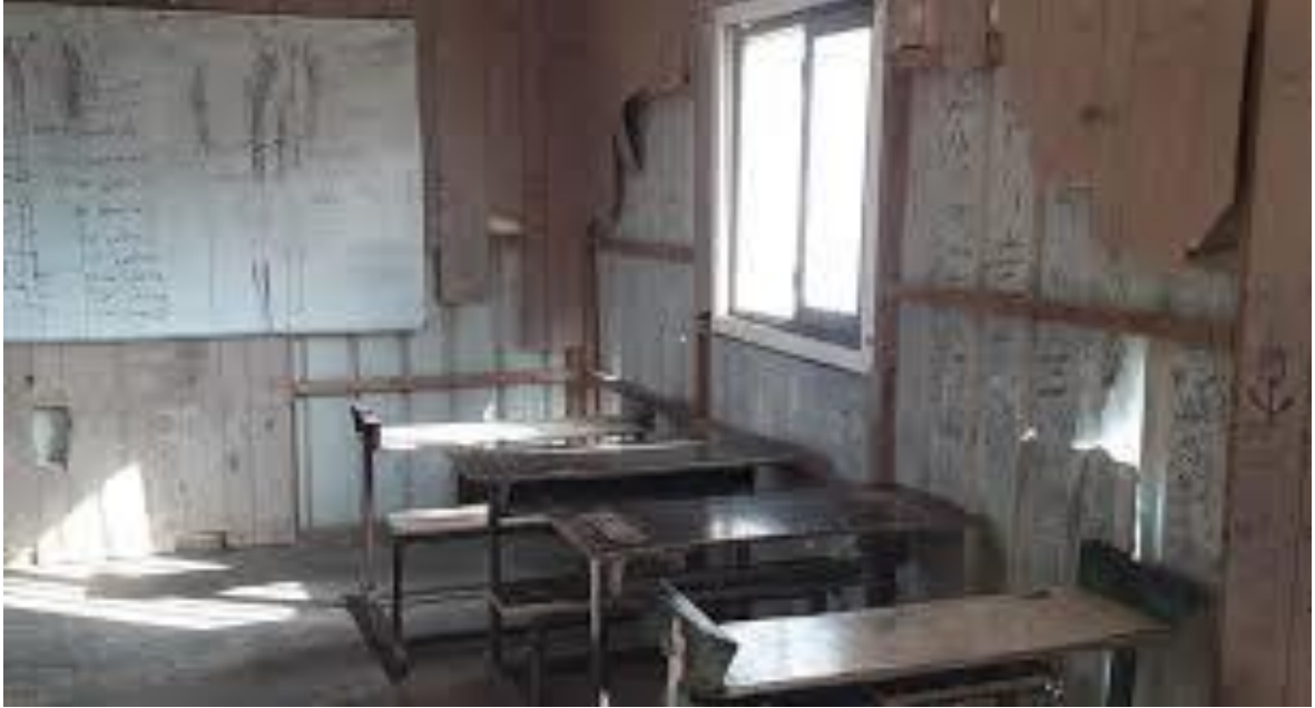
الصورة (٤) تهالك الابنية المدرسية
